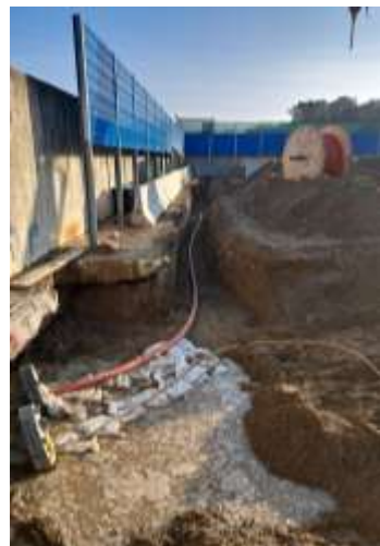
Giunti interrati terra/mare cavi TLC e MT
